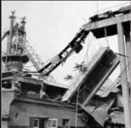
地震破坏后的唐山钢铁公司炼铁厂
