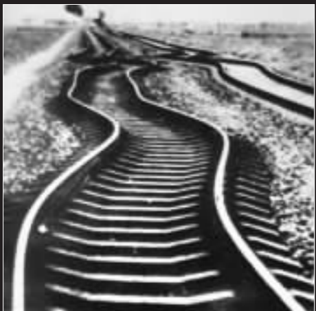
地震破坏后的铁路
