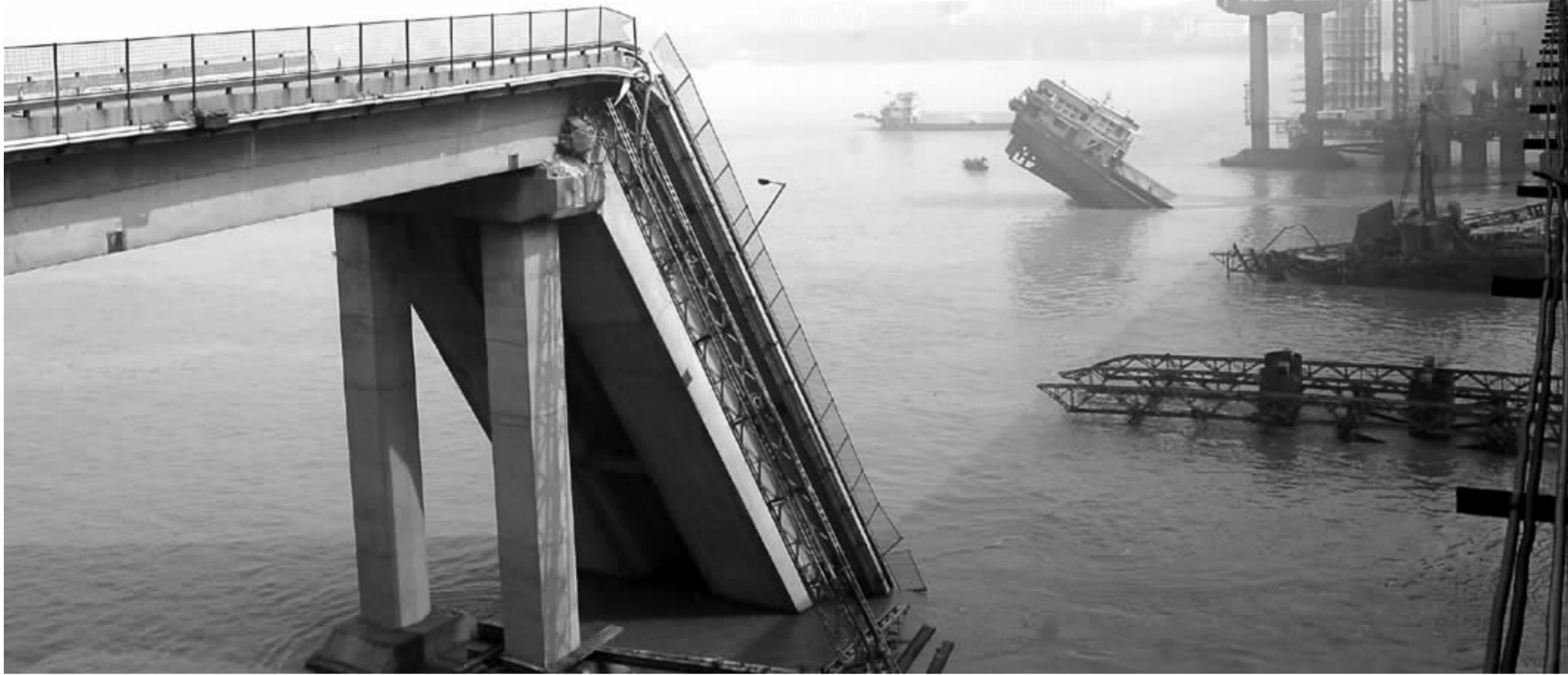
15日凌晨5时许,325国道广东佛山九江大桥发生运沙船撞击桥墩事件,导致九江大桥桥面部分断裂 本报传真图
