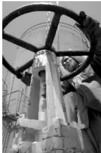
伊拉克石油管道 资料图
