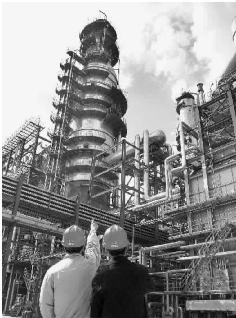
中国石油辽阳石化公司化工装置 资料图
