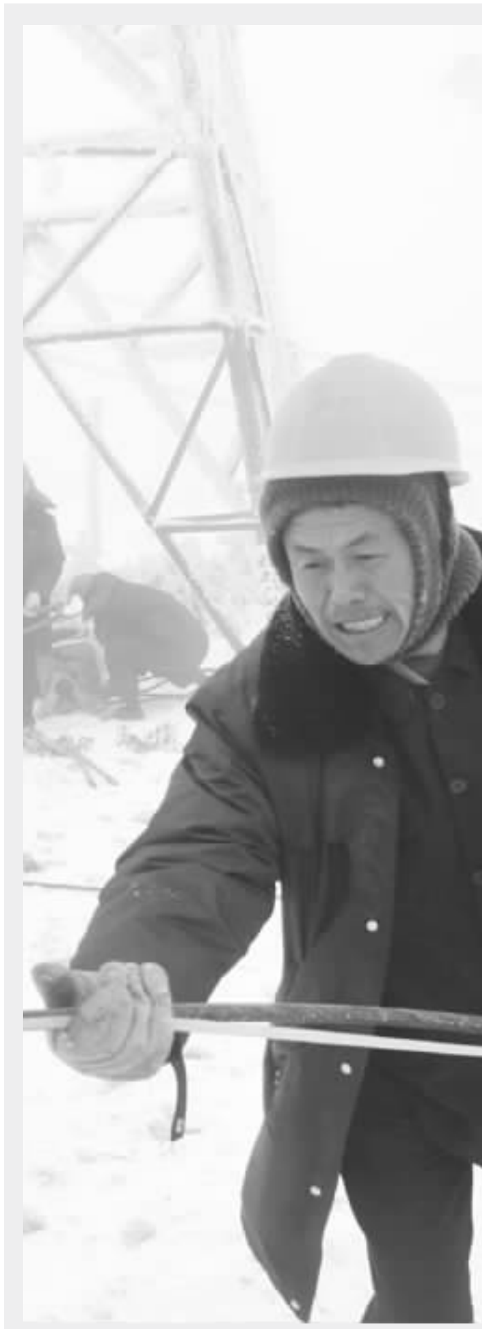
截至 1 月 31 日 12 时,全网累计有 5242 条线路故障停运,2284 条线路抢修恢复运行,仍在抢修的有 2958 条
