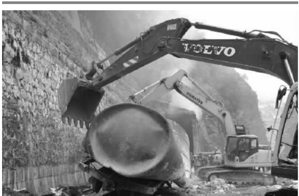
20日下午3时许,随着最后一辆油罐车被救援车拖出隧道,因地震造成成宝铁路109号隧道塌方后被围在隧道内的12节起火燃烧的油罐车已被全部清理出洞 新华社图
