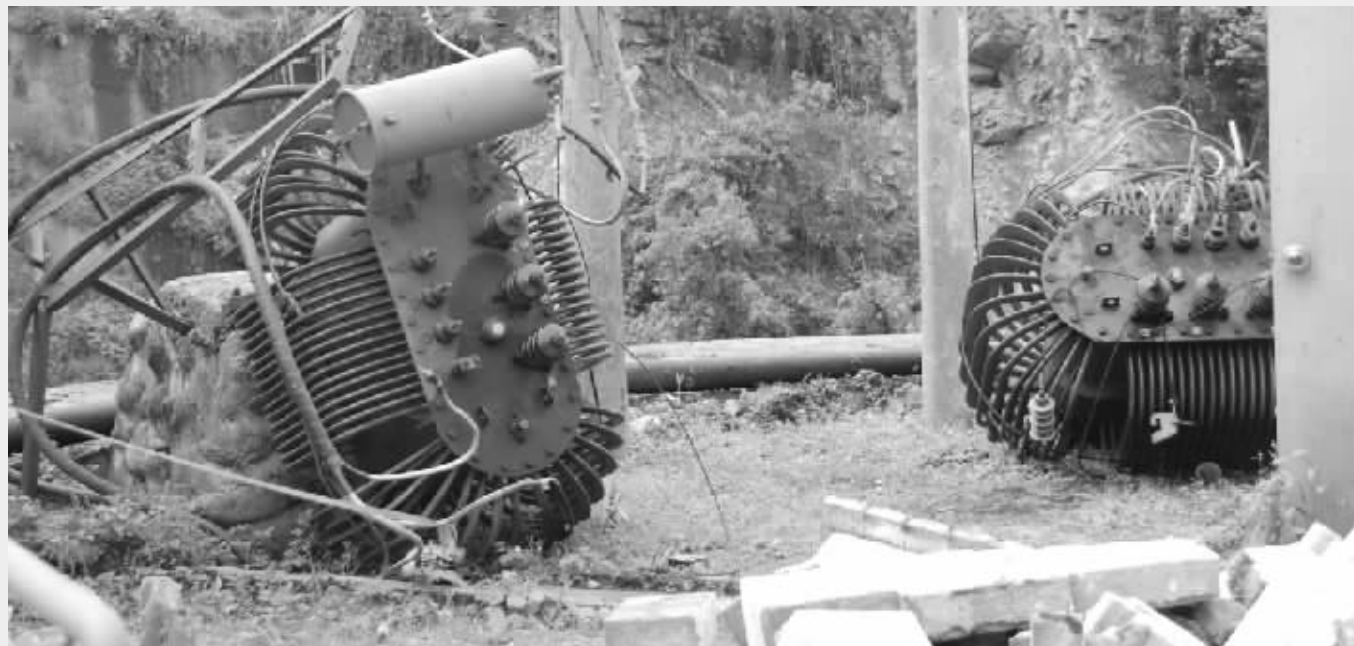
天彭电力厂所在地震中受损的厂用变压器 本报记者 陈其珏 摄
