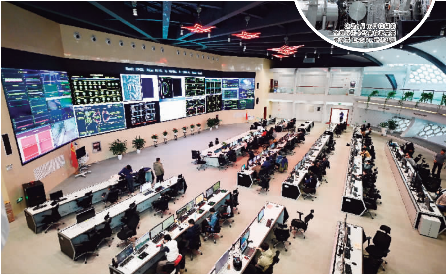
1月20日拍摄的全超导托卡马克核聚变实验装置(EAST)控制大厅。 新华社图
