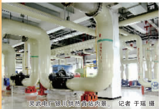
灵武电厂银川供热首站内景。记者 于瑶 摄
