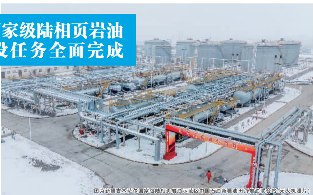
图为新疆吉木萨尔国家级陆相页岩油示范区中国石化新疆油田页岩油联合站（无人机照片）
