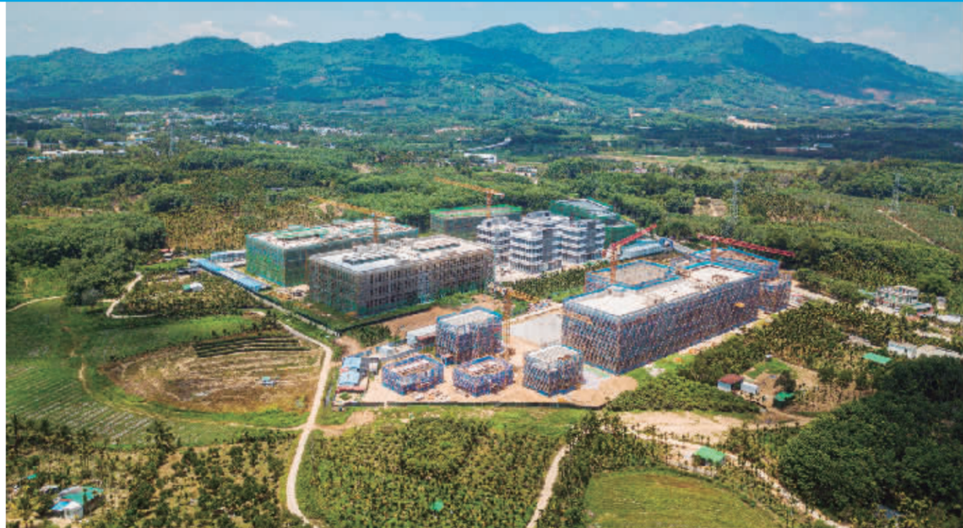
图为6月3日在海南保亭拍摄的建设的中欧(保亭)绿色数字创新合作区加茂医疗健康产业园项目。中欧(保亭)绿色数字创新合作区，是海南建设国家生态文明试验区的标志性工程。合作区将建设宁远起步区、加茂医疗健康产业园等重点片区，构建绿色低碳产业体系，发展绿色数字经济，推动保亭经济实现高质量发展。 目前，宁远起步区主路项目正在进行管廊结构、路基回填等施工；加茂医疗健康产业园项目正在进行主体结构、墙体砌筑、室内装修等施工。合作区各项建设有序推进。 新华社图文
