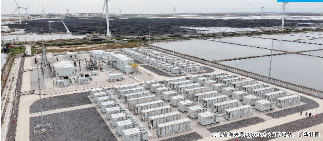
河北省海兴县200兆瓦级储能电站。新华社图
